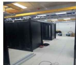
机房工程子系统
